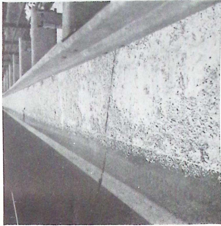
Slika 1 — Površinsko ljuštenje betona vjerojatno stabe površinske zaštite nakon ugradnje
